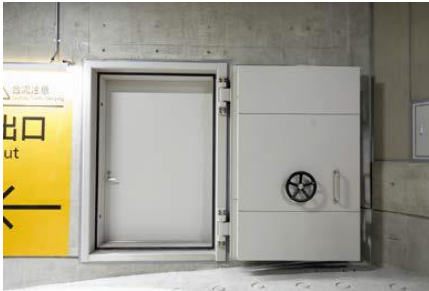
水密扉（地下機械室）
